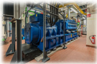
コジェネレーションシステム
